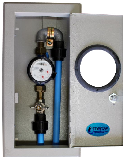
Detalle instalación micro-medidor con válvula antifraude
